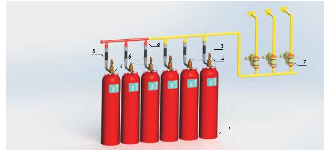
Автоматическая установка газового пожаротушения: 1 – модуль МПА-NVC1230; 2 – электропривод (соленоид) NVC; 3 – ручной привод (локальный) NVC; 4 – реле давления; 5 – РВД NVC; 6 – пневмопуск на 2 модуля; 7 – распределительное устройство; 8 – обратный клапан
